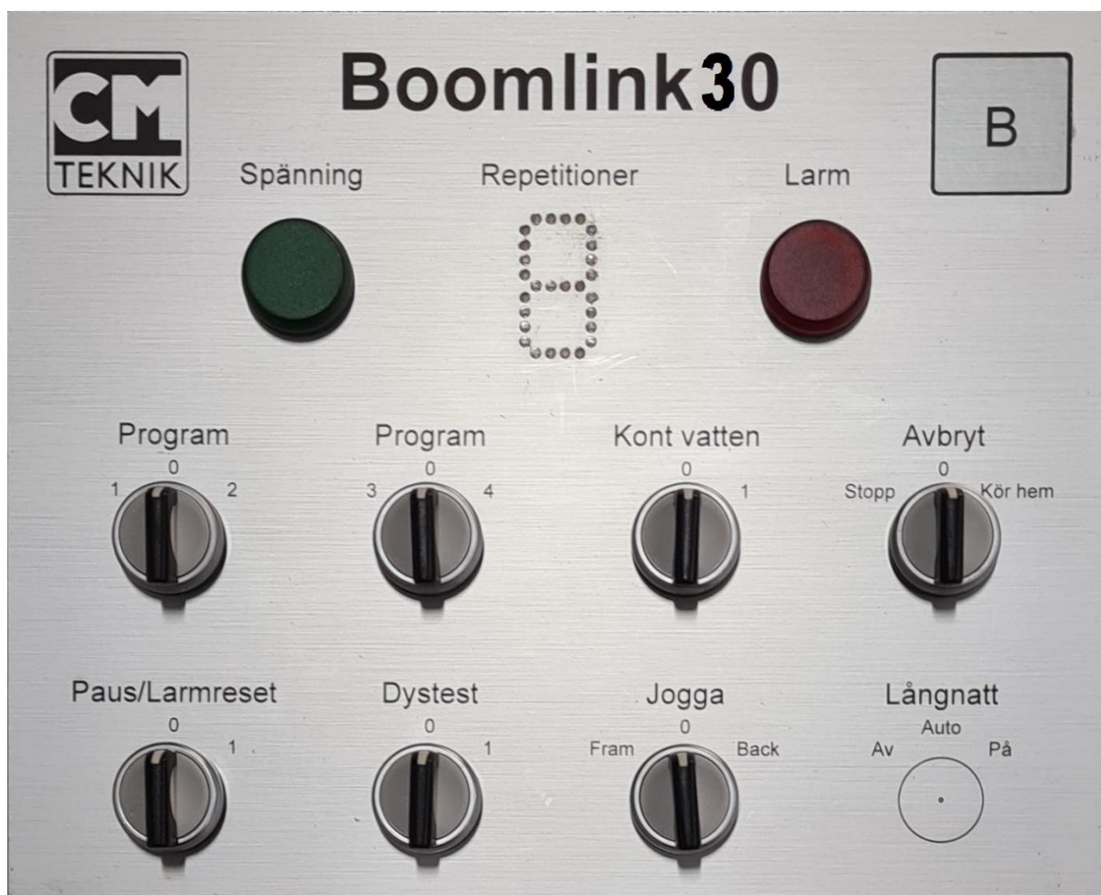
Frontskylt på styrcentralen.
